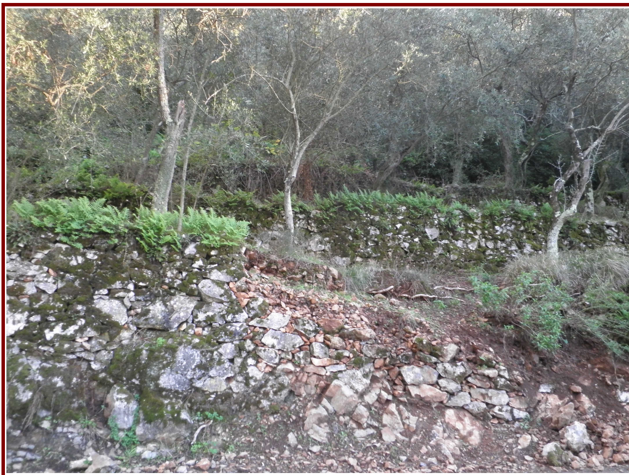
Terrazzamento parzialmente franato
